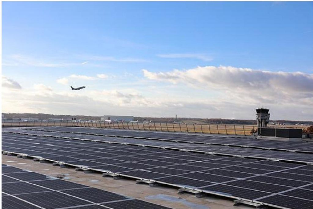
Les panneaux photovoltaïques qui couvrent le toit du parking P2 Crédit photo : ©ATB / Guillaume Serpault
