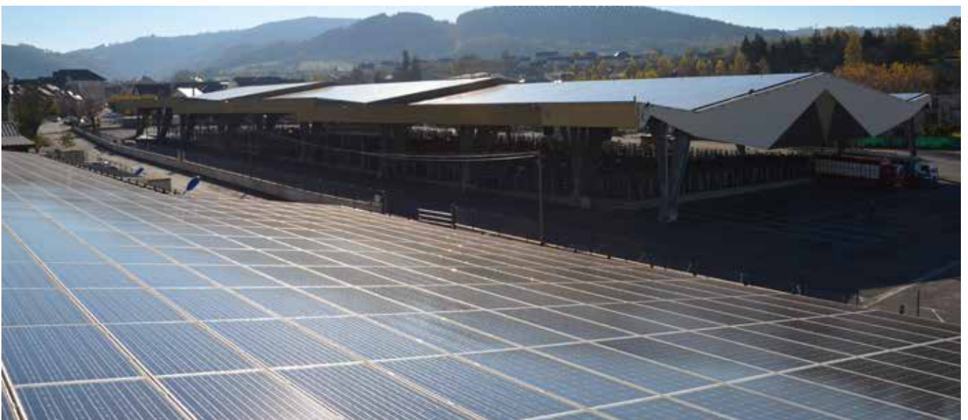
Marché aux bestiaux - Laissac (12) : Maintenance de la toiture solaire - 1,4 MW
