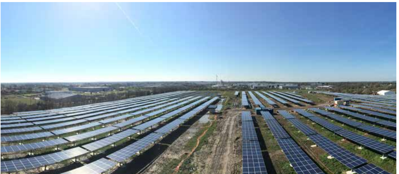
Centrale au sol - Le Poiré-sur-Vie (85) : Maintenance de l'installation solaire photovoltaïque - 5,2 MW
